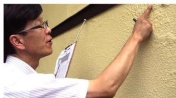
ドアや窓の開閉状況確認。 外壁の浮きやハガレをチェック。
